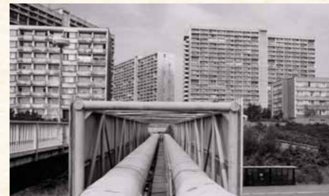
Horkovodní potrubí v Chomutově.
